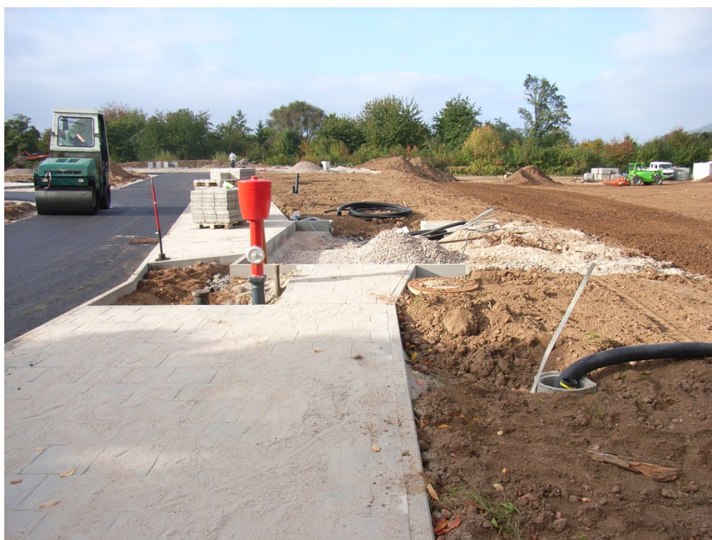
Acceso al helipuerto con hidrante
